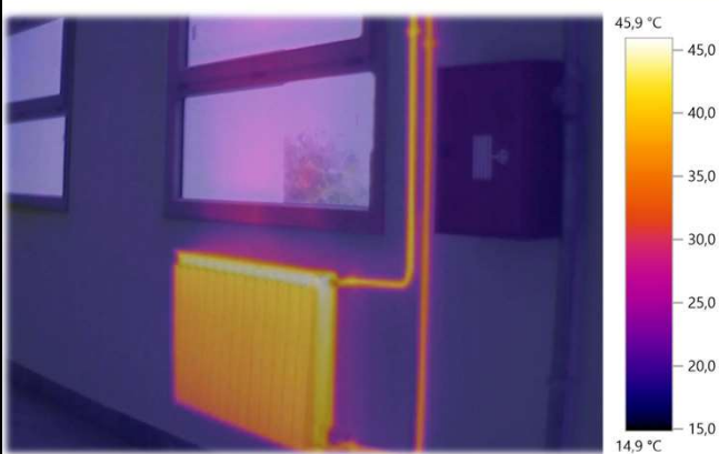
Istituto Comprensivo Statale Sebastiano Satta – Via della Vittoria Carbonia Analisi Termografica Radiatore – funzionamento a bassa temperatura
